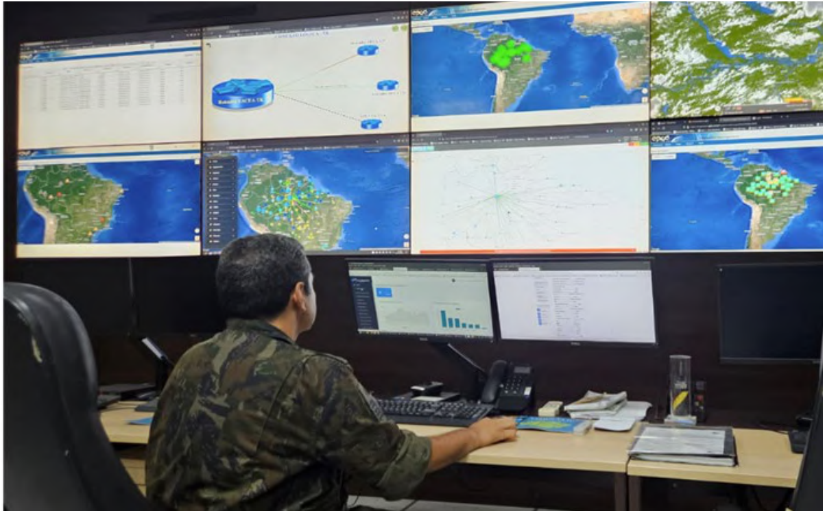
Nova infraestrutura das Salas Técnicas dos CINDACTA e do CRCEA-SE
