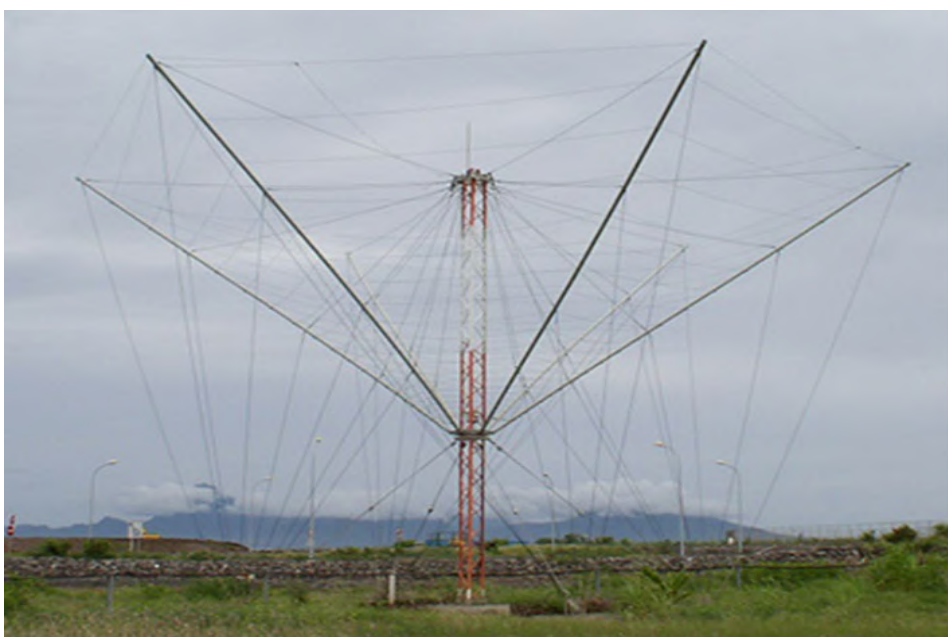
Antena para transmissão HF
